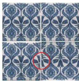
Cette disposition est incorrecte : les motifs sur les côtés ne sont pas alignés car le carreau en bas à droite est à l'envers
